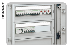
Détail du système de repérage des circuits.
